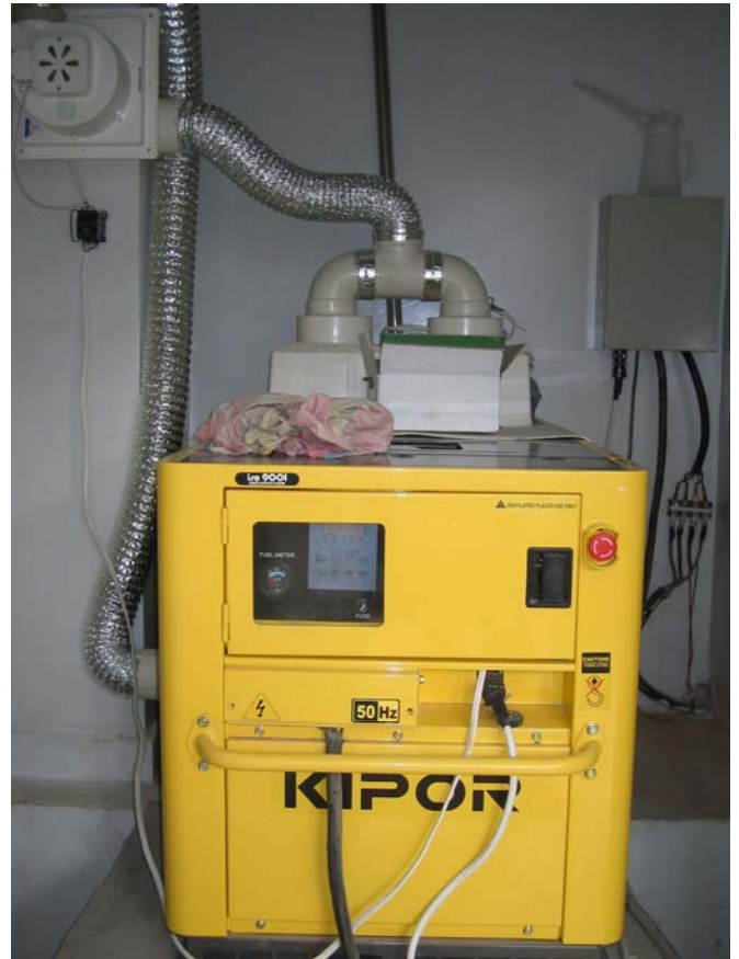
Dieser Notstromgenerator gewährleistet zukünftig auch während der häufigen Stromausfälle die elektrische Versorgung der lebenserhaltenden Geräte auf der Intensivstation.
