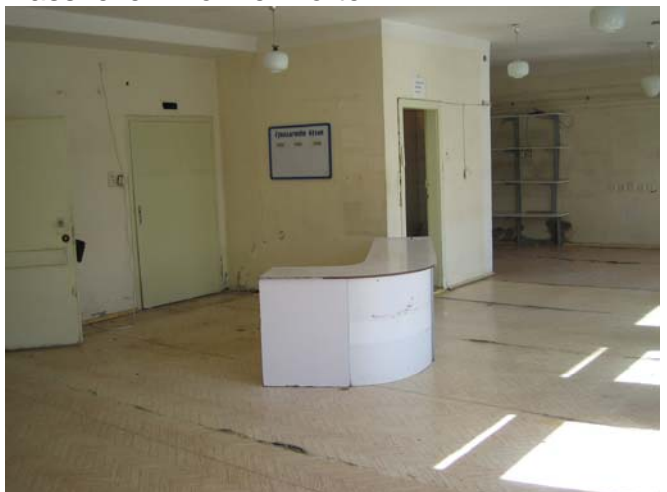
Alles in allem: renovierungsbedürftig!
